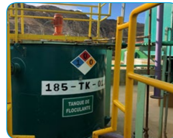
Preparación de floculante-PTAA THY
