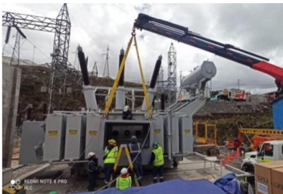
Imagen N°13: Implementación de Transformador de 30/36 MVA
